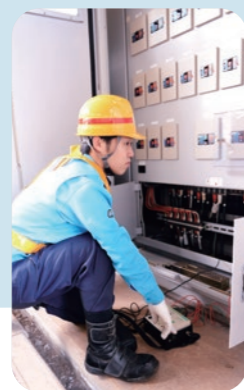
2 9:15 高圧線設備点検。駅内に送り届ける電気の設備点検です。
